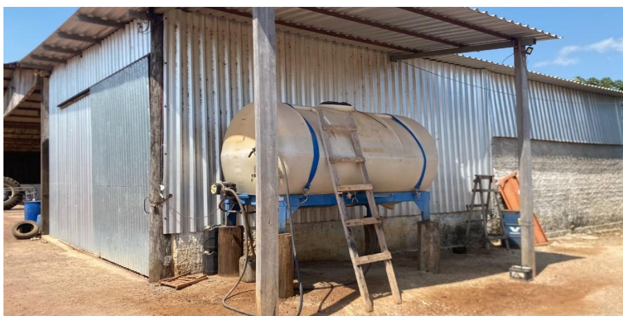
Figura 35. Tanque para abastecimento de combustível.
